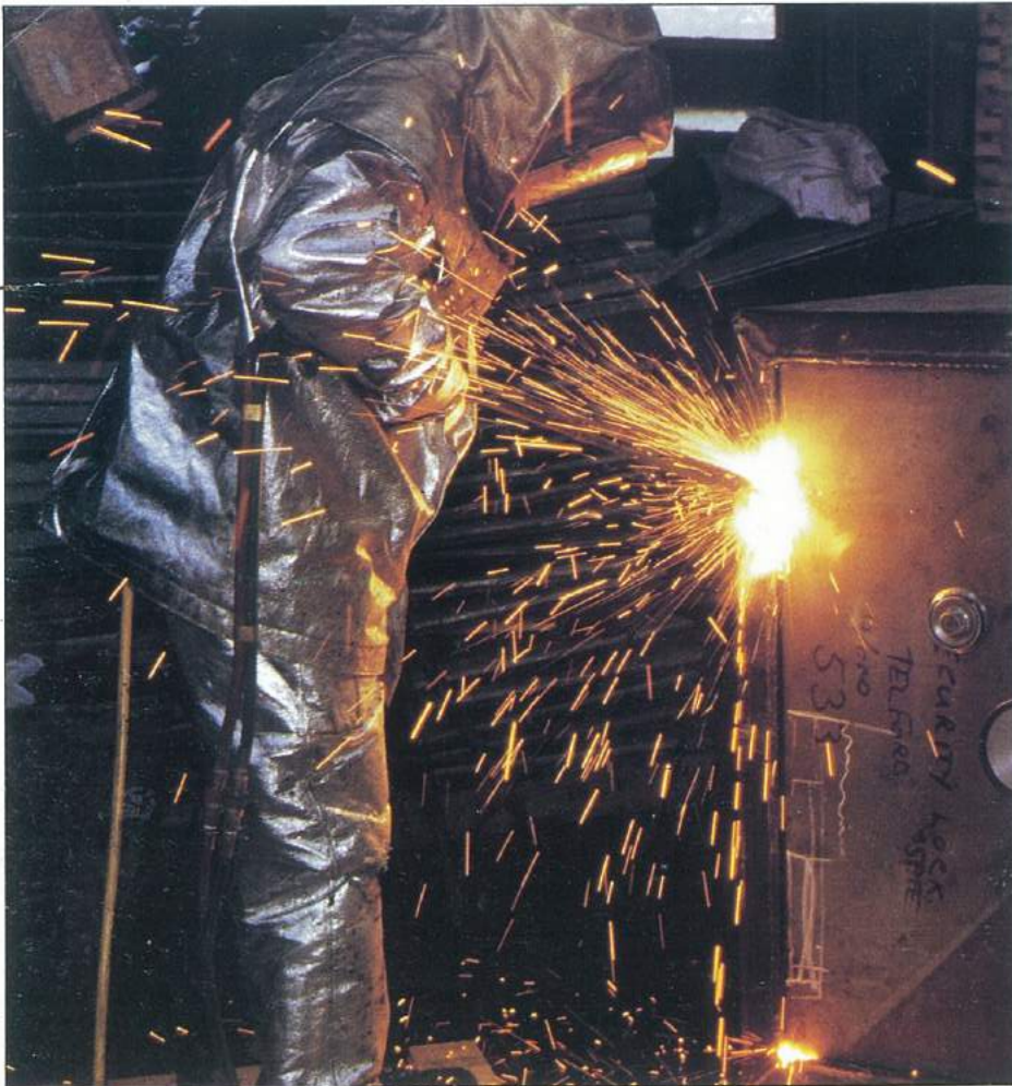
UL Torch/Tool Attack on Safe Door Jamb
